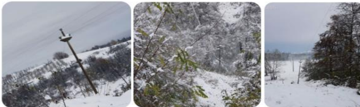
Novembre 2019. Effetti delle nevicate: caduta sostegni, rottura conduttori delle linee aeree e caduta piante (Piemonte)
