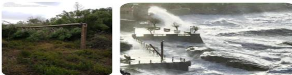
Dicembre 2019. Effetti del vento: caduta sostegni, rottura conduttori delle linee aeree e caduta piante (Toscana)
