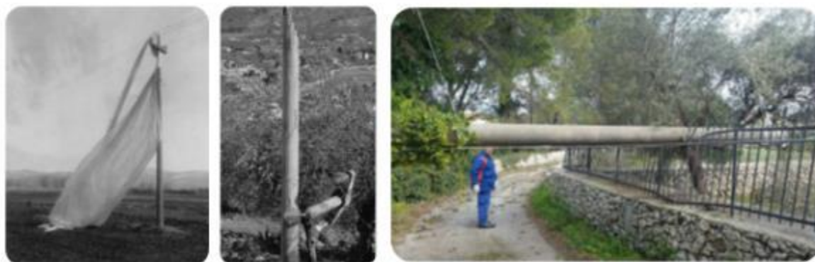
Febbraio 2019. Effetti del vento: caduta sostegni, rottura conduttori delle linee aeree e caduta piante (Lazio e Sicilia)
