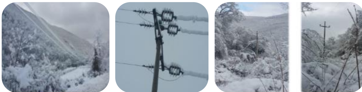
Dicembre 2018. Effetti delle nevicate: caduta sostegni, rottura conduttori delle linee aeree e caduta piante (Marche)
